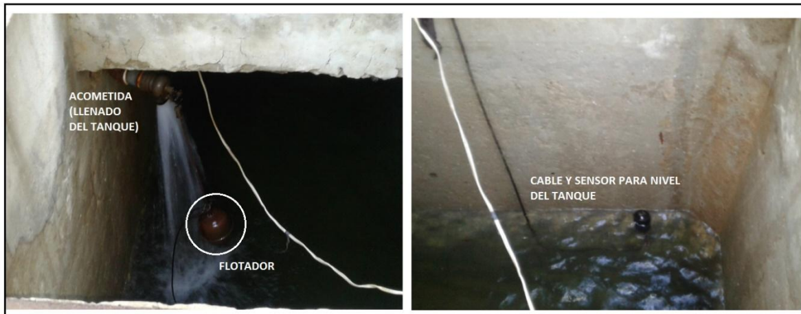
Figura 13. Llenado tanque de almacenamiento
