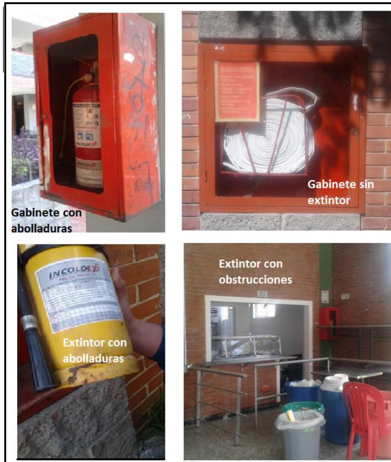
Figura 14. Novedades de la inspección visual de los extintores
