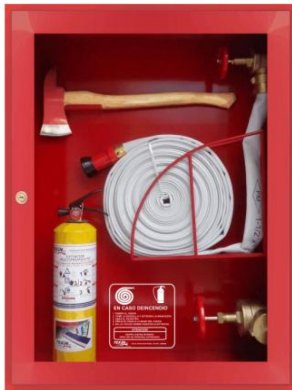
Figura 2. Gabinete contra incendio a base de agua como agente extintor.
