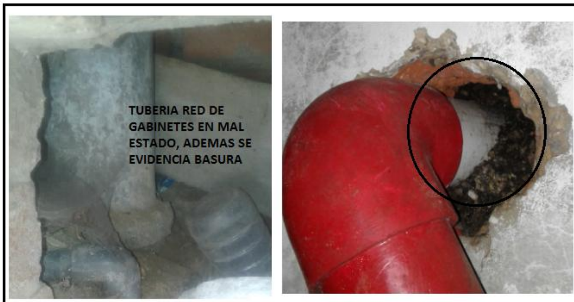
Figura 5. Tubería de la red contra incendios. Gabinetes
