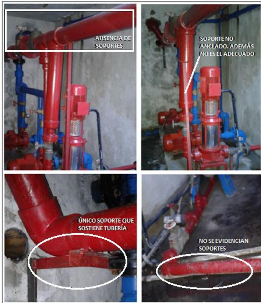
Figura 9. Tubería del cuarto de bombas
