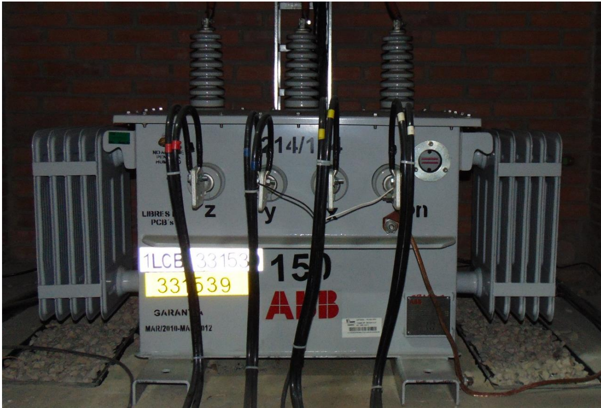
Figura 2.5. Transformador de potencia
