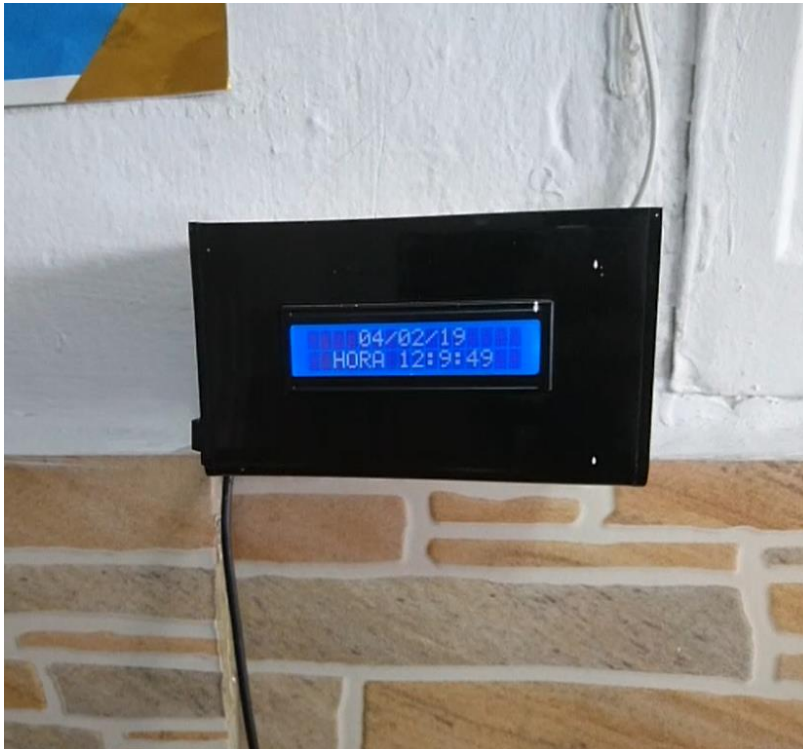
Figura 13. Controlador de timbre de cambio de clase, fuente: autor.
