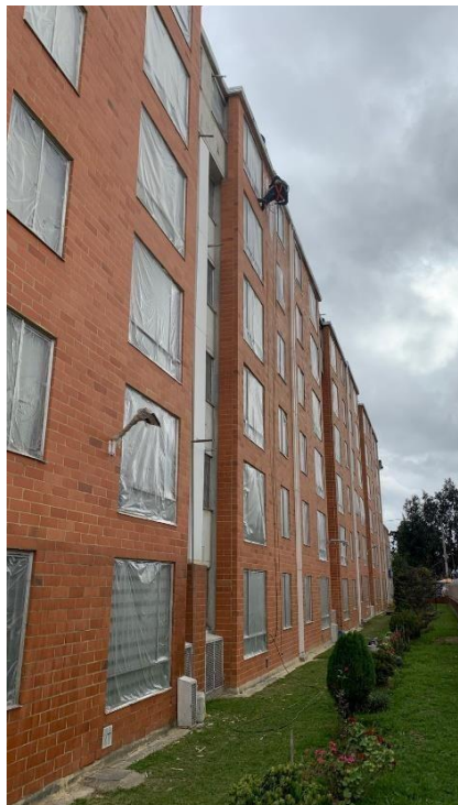
Ilustración 17. Protección de ventanería (Madeiro 1)
