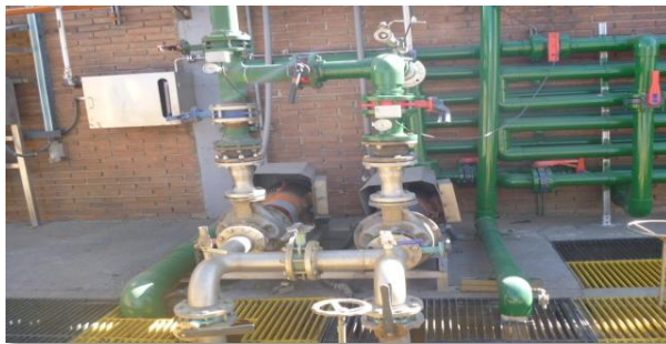
No. 1 Sistema de bombeo agua potable
