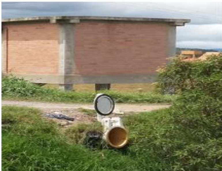
Figura N° 11. Obras de Bombeo del Distrito de Riego. Copyright por el autor. 2018.
