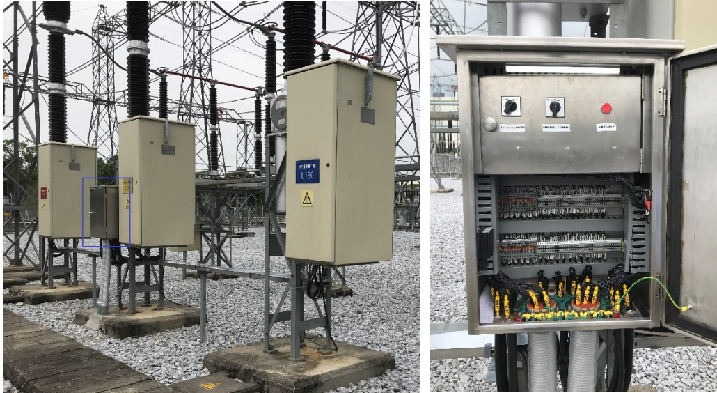
Figura 23. Tablero de agrupamiento del interruptor, nivel 0.
