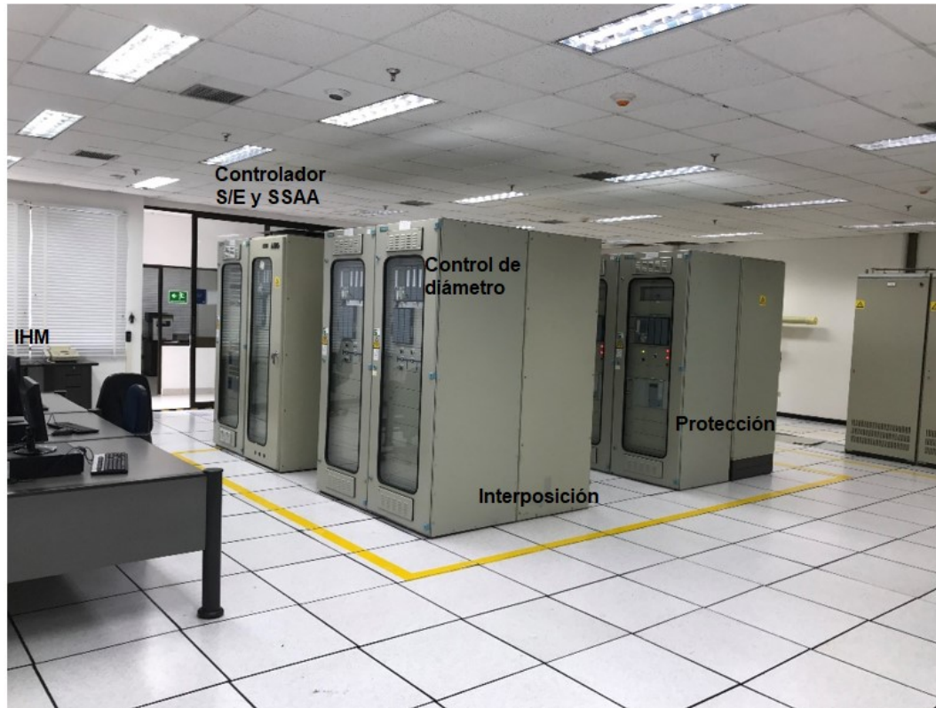
Figura 29. Disposición final tableros de protección y control Sala de Control S/E La Sierra.
