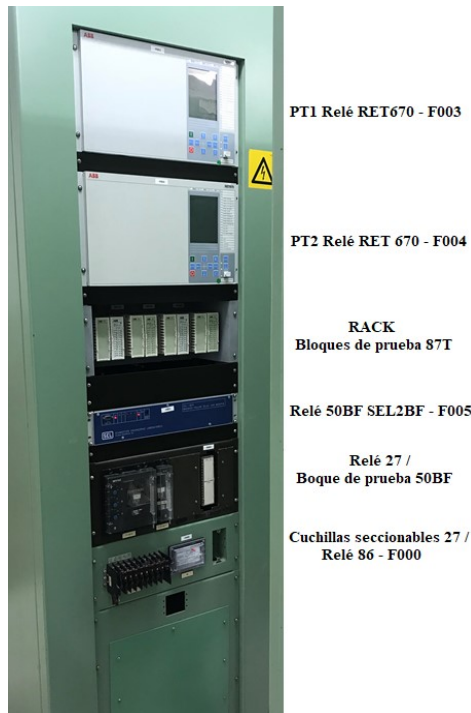
Figura 11. Gabinetes de protección de Transformador S/E Toledo.
