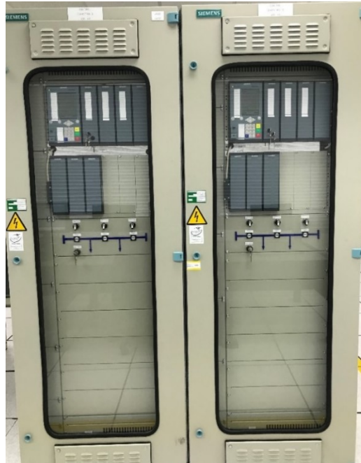
Figura 24. Nuevos Gabinetes de control de diámetros 2 y 3, S/E La Sierra.
