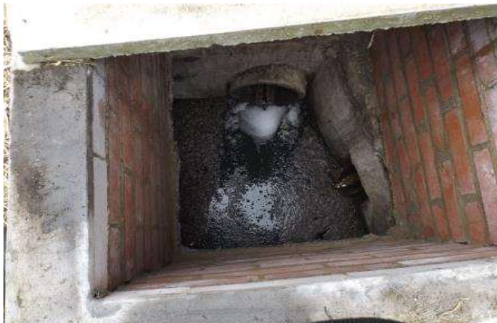
Imagen 2. Trampa de grasas en la salida de los restaurantes del centro turístico. Numpaque, 2015.
