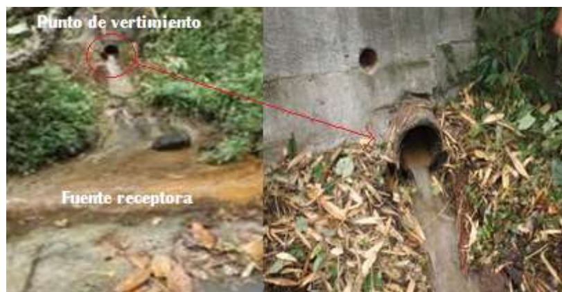
Imagen 4. Punto de vertimiento de aguas residuales sobre la fuente hídrica receptora. Numpaque, 2015.
