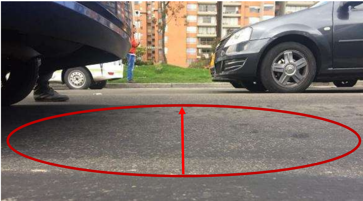
Ilustración 8 Deterioro de la estructura, ahuellamiento severo
