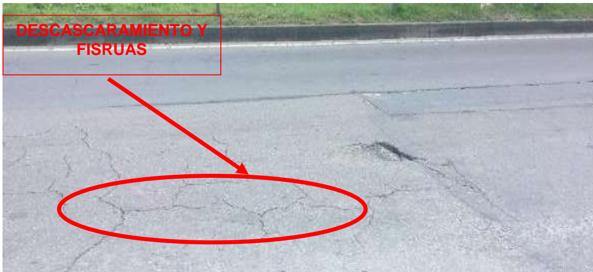
Ilustración 9 Daño tipo descascaramiento y fisuras
