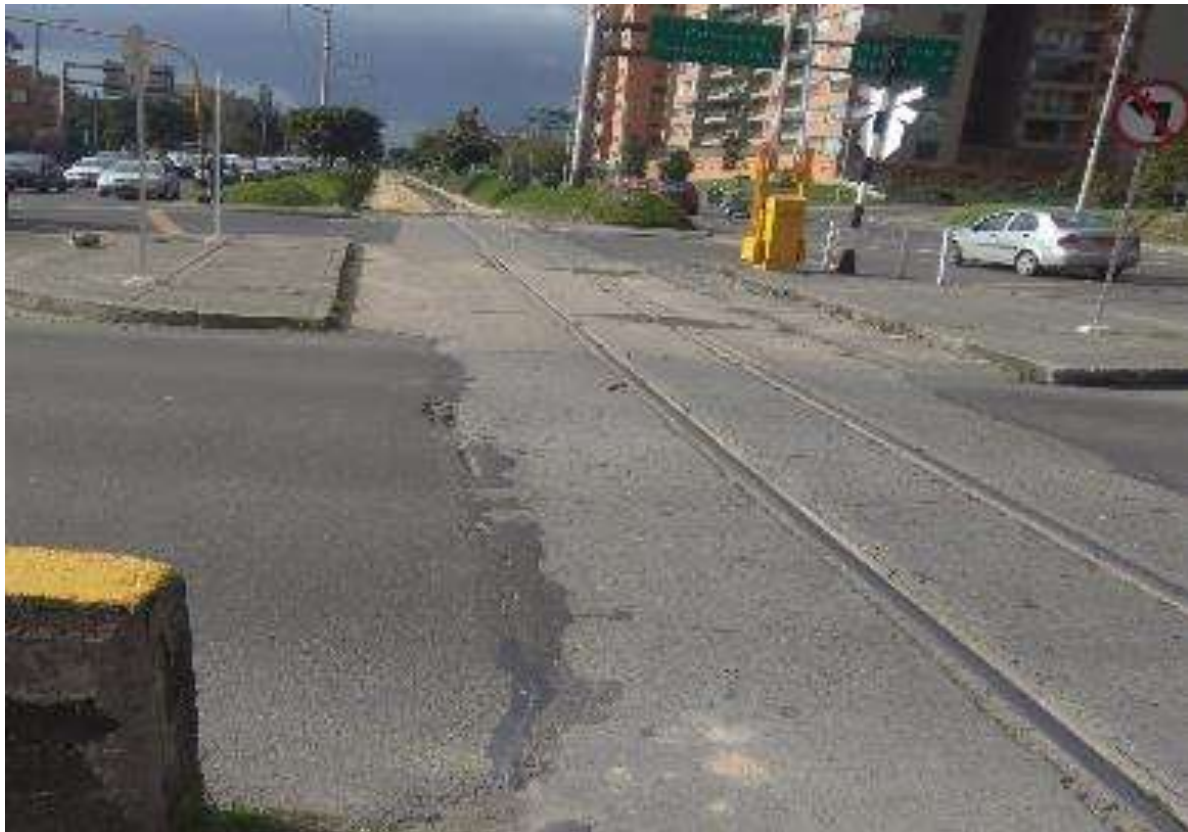
Ilustración 28 Sobresalto en la unión de línea férrea
