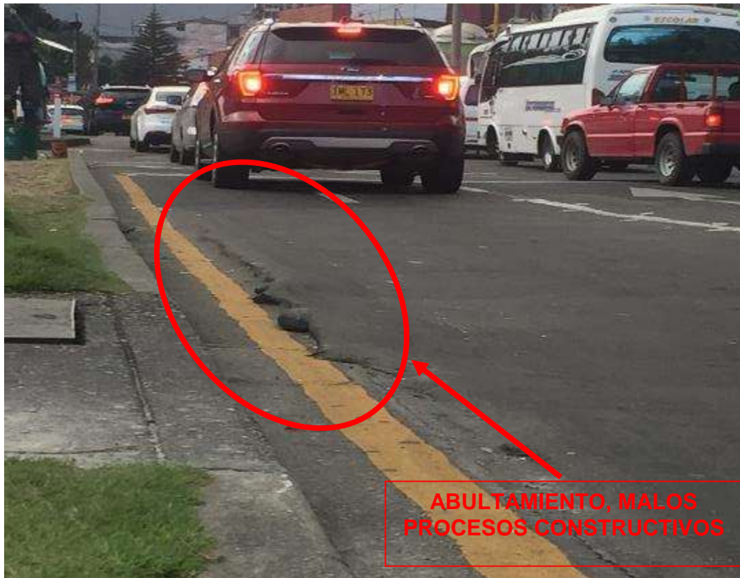
Ilustración 6 Deterioro de la estructura, Abultamiento. Malos procesos constructivos
