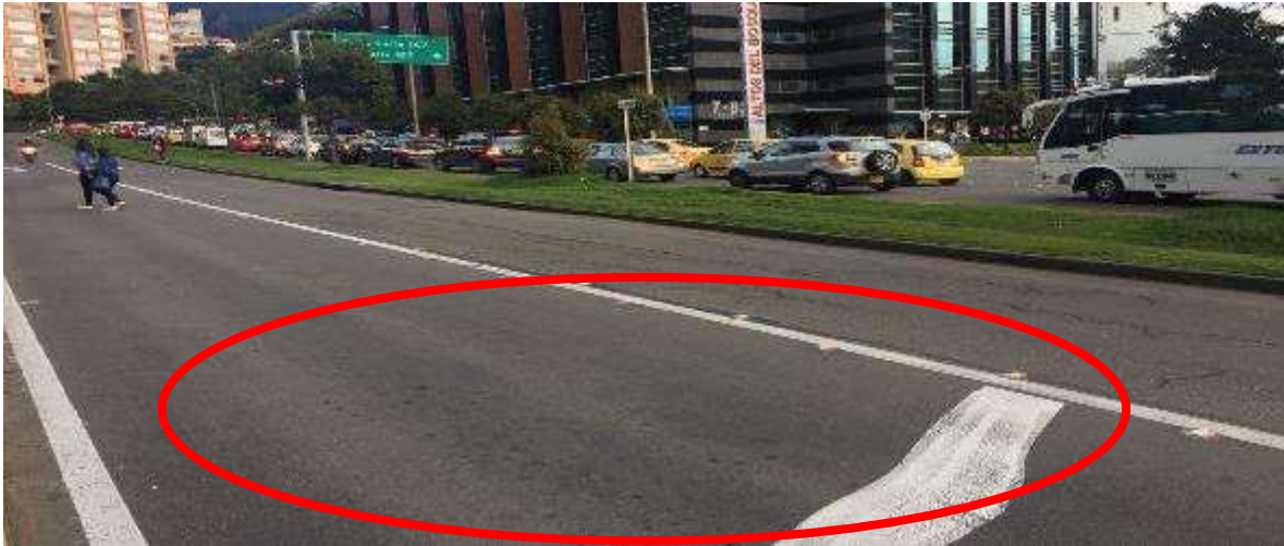
Ilustración 7 Deterioro de la estructura, ahuellamiento
