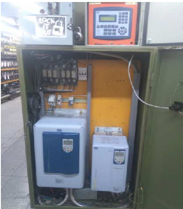
Fig.9 Tablero de control después de la modificación.
