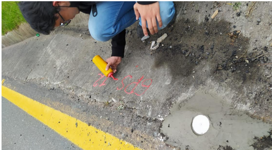
Figura 5. Placas metálicas incrustadas y geo referenciadas
