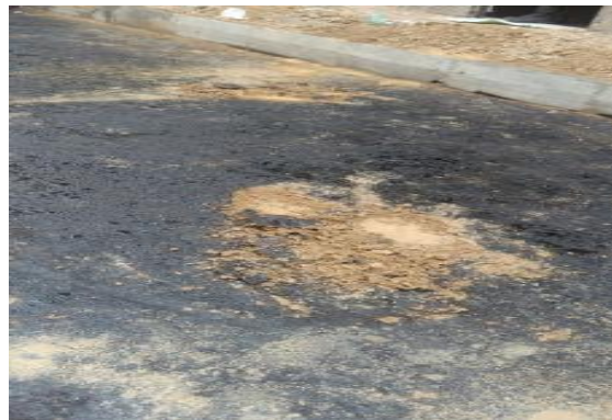
Figura 29. Segregación de base granular Fuente: propia
