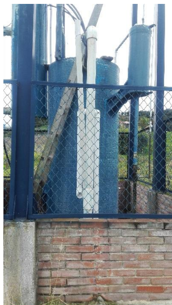
Imagen 13. Tanque de cloración.
