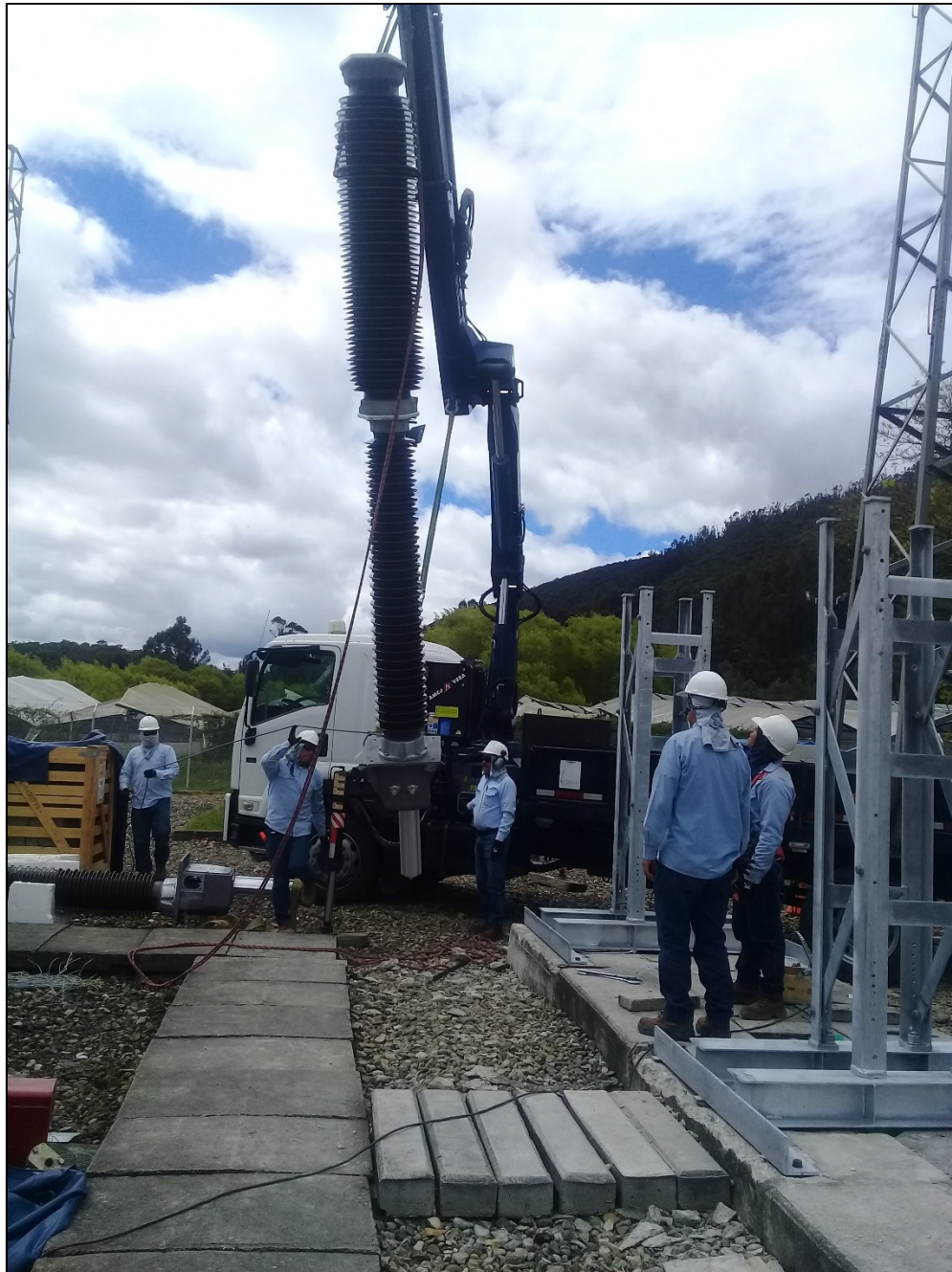
Anexo 12 Mantenimiento bahía Guavio I, S/E Torca
