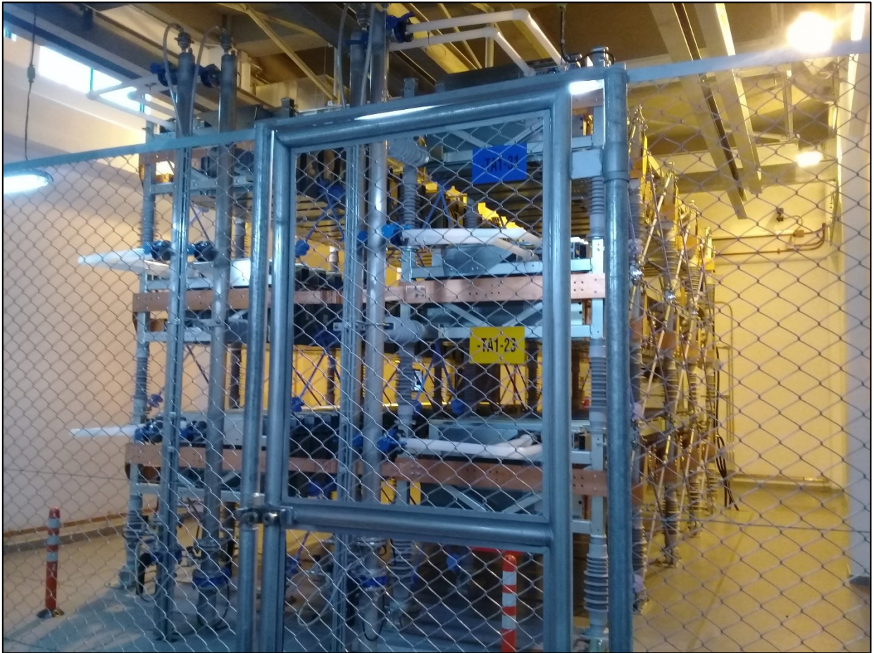
Anexo 17 Módulos del Convertidor STATCOM
