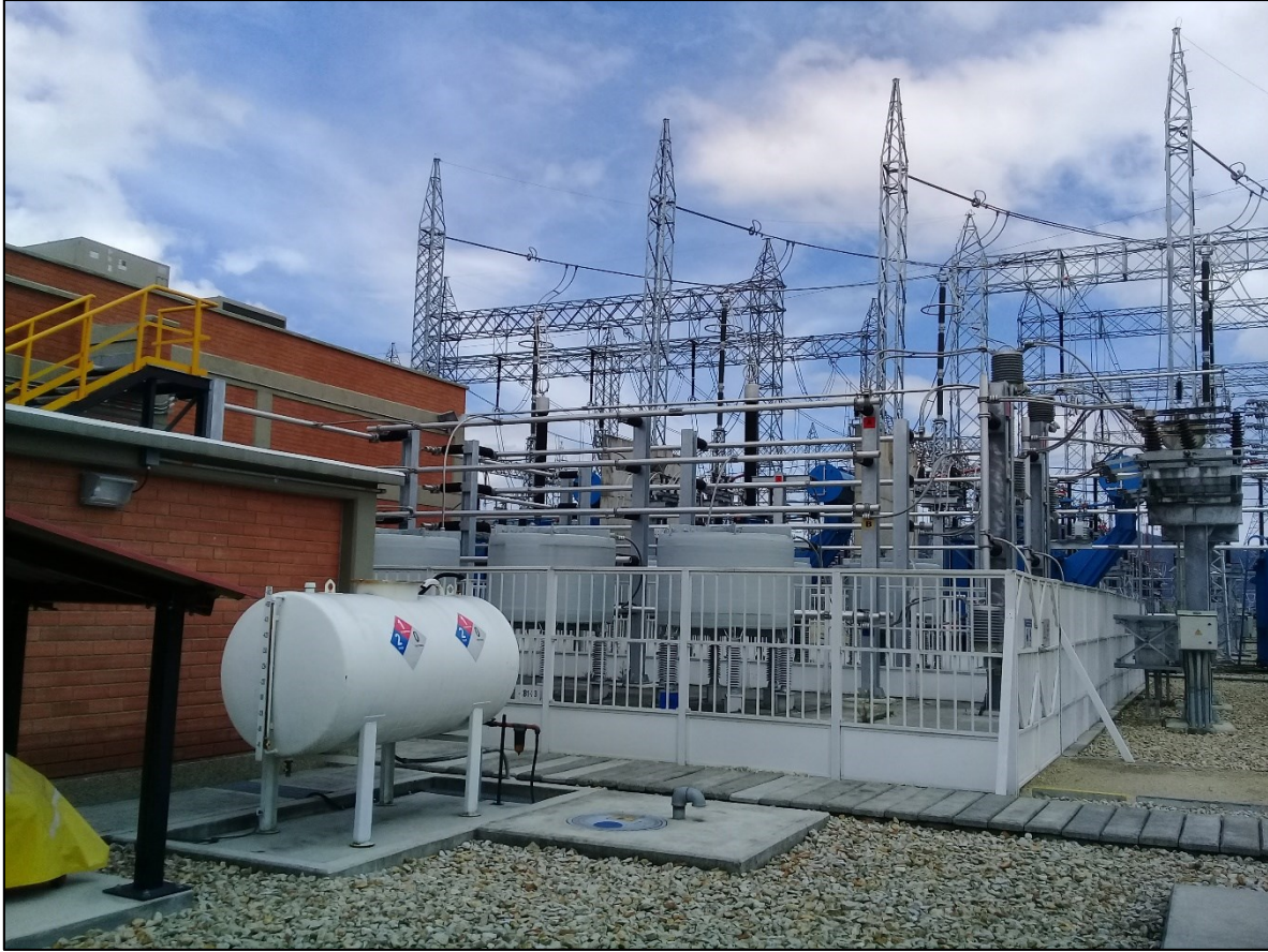
Anexo 18 STATCOM VISTA EXTERIOR.
