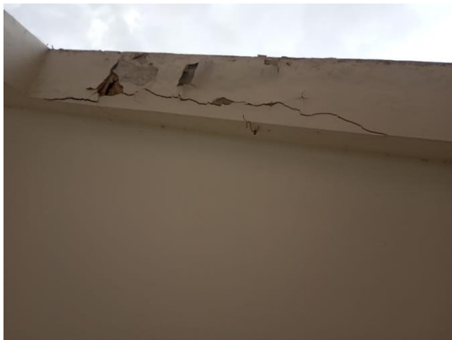
Imagen 10 Estado de la infraestructura Palacio Municipal
