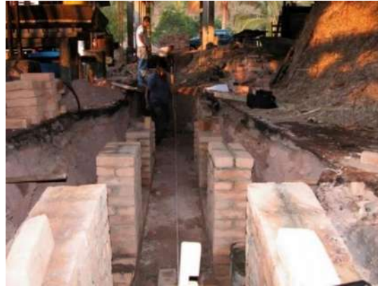
Figura 17. Ducto de gas o humo
