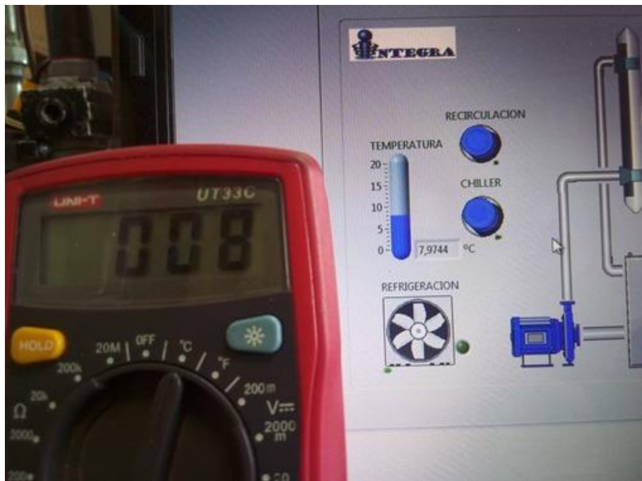
Figura 5. Comparación SCADA con medida del patrón de medida utilizado, elaboración propia
