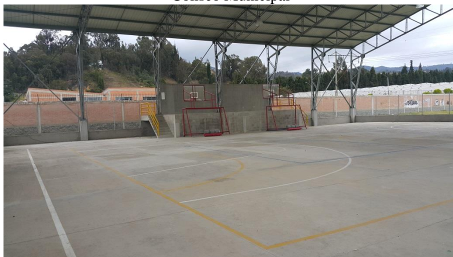
Cancha Múltiple (Falla estructural)
