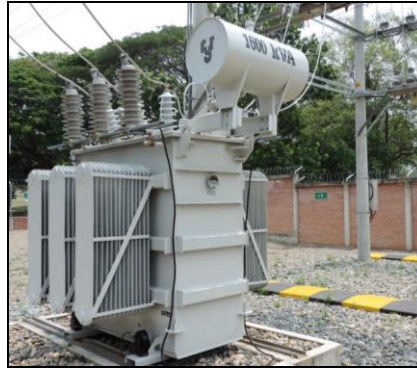
Figura 3. Transformador de potencia FyR de 1600 kVA, (FyR, 2017)
