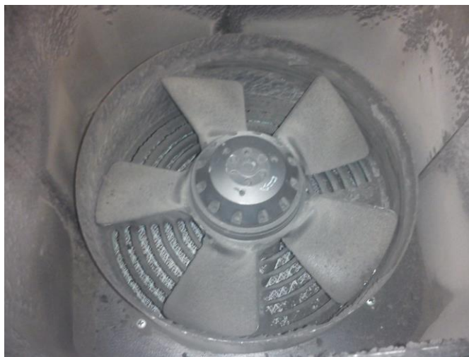
Ilustración 12. Ventilador del motor INDRAMAT
