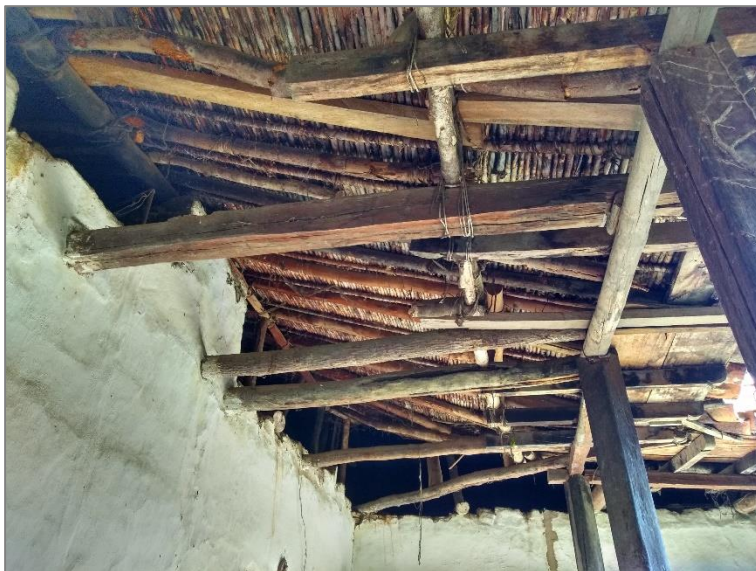
Ilustración 28. Detalle de estructura de cubierta sobre muros de tapia. Fuente: Captura propia.
