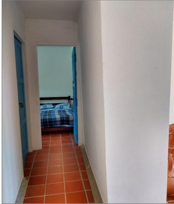
Ilustración 40. Detalle de acceso a las habitaciones, acabados de piso. Fuente: Captura propia.
