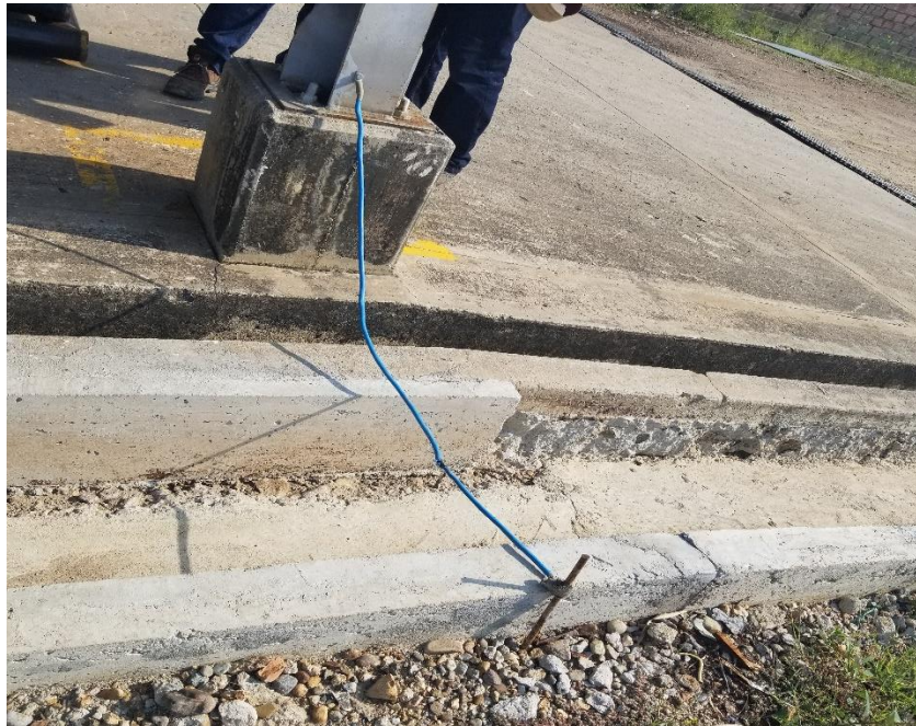
Imagen 15. Registro fotográfico no conformidad
