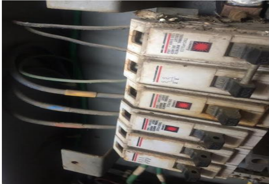
Imagen 11. Registro fotográfico no conformidad
