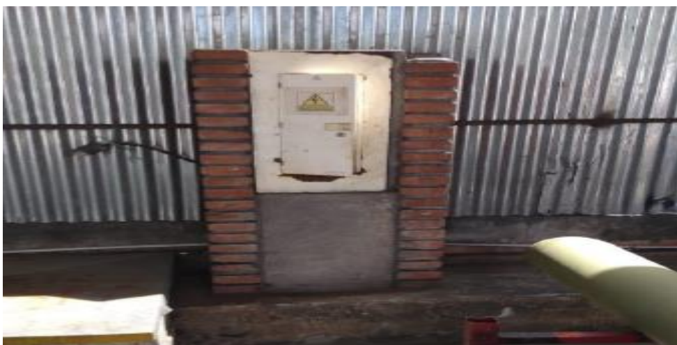
Imagen 11. Registro fotográfico no conformidad
