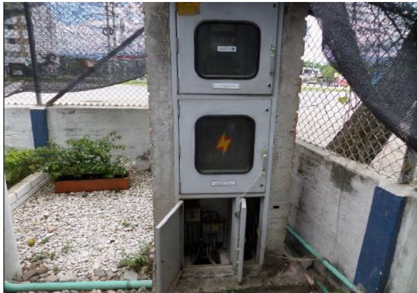
Imagen 7. Registro fotográfico no conformidad
