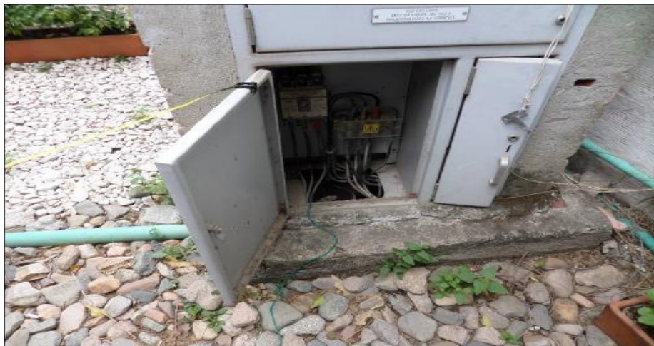
Imagen 9. Registro fotográfico no conformidad
