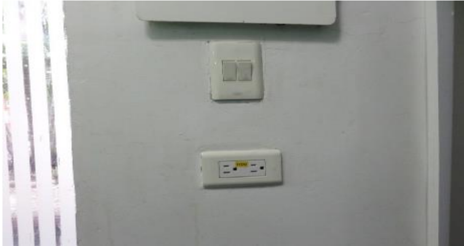
Imagen 13. Registro fotográfico no conformidad
