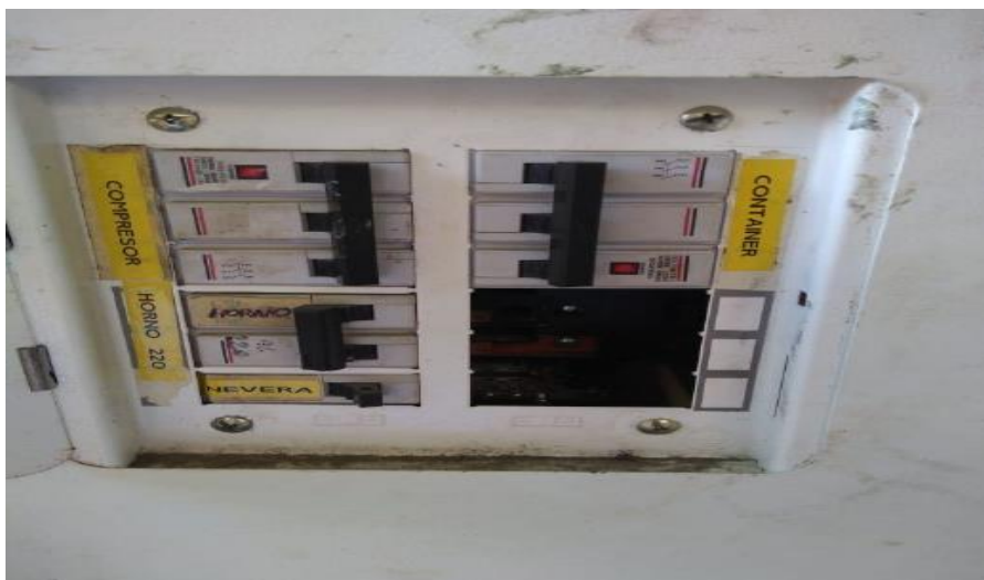
Imagen 12. Registro fotográfico no conformidad
